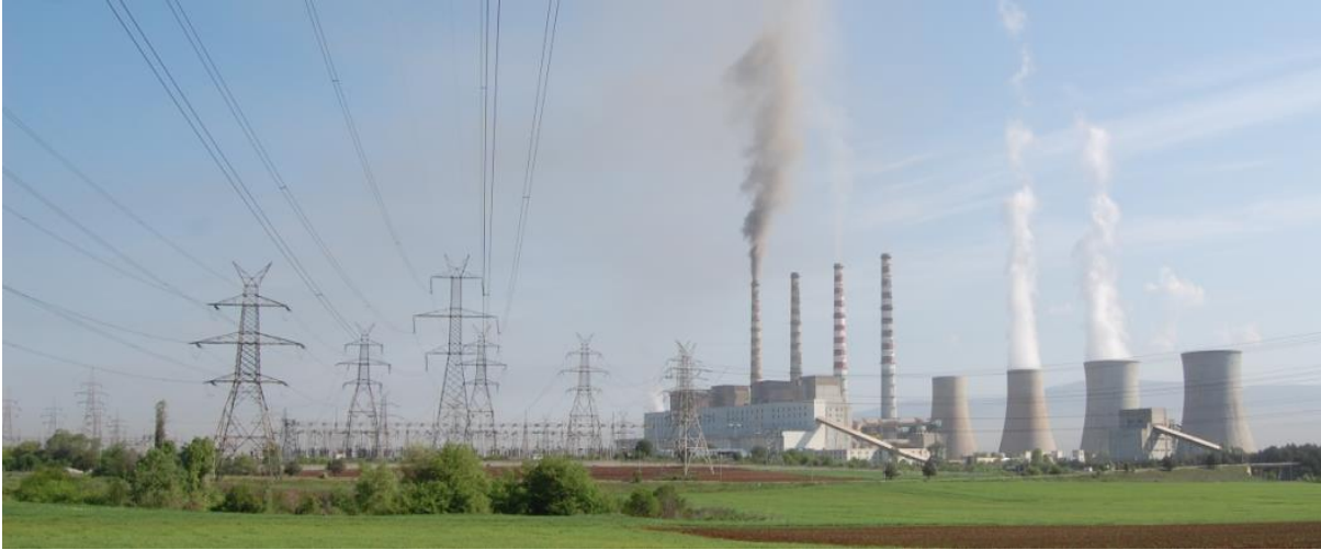
1. ábra A villamosenergia termelés (széntüzeléses blokkok hűtővíztornyokkal) és a szállítás (alállomás, nagyfeszültségű távvezetékek) üzemei (a MAVIR kiadványaiból)
